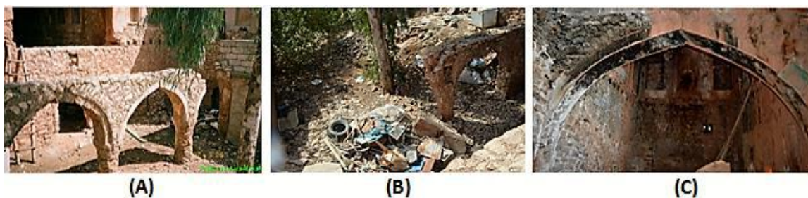
Fig. 15, (A) L'arc brisé du riwāq encore debout (2007) et (B) l'arc brisé de riwāq ruiné (2014), (C) un arc brisé dans la chambre occidentale.
